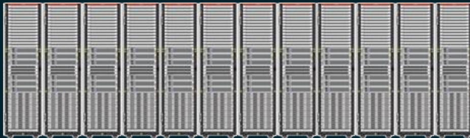
Standardowe szafy rack chłodzone powietrzem 500kg-600kg na szafę, 12 kW na szafę
